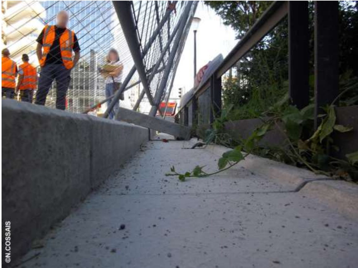
Figure 101 : Caniveau de collecte des eaux pluviales rue Garibaldi à Lyon. Visite dans le cadre du projet Ville Perméable, en présence des équipes d'entretien. Photographie du 24 juin 2016.
