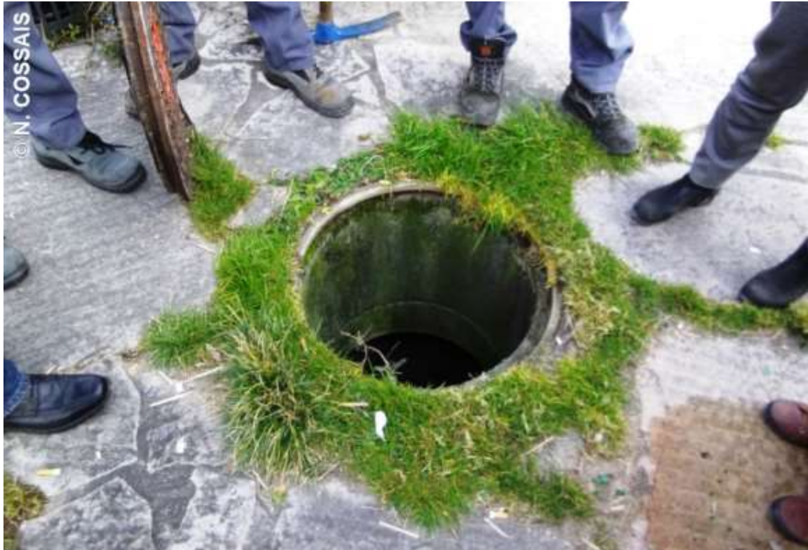
Figure 113 : Réunion autour d'un puits d'infiltration sur le parvis de l'Ecole Normale Supérieure à Lyon (Cossais et Sibeud, 2017a, p. 212). Photographie du 13 mars 2015.
