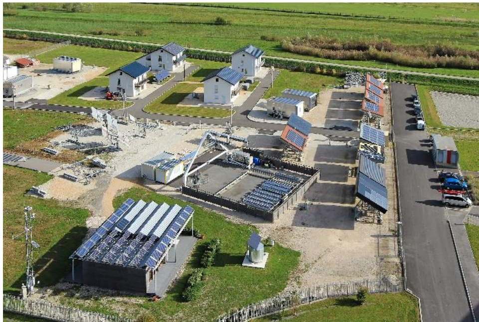
Figure V-6 : Les maisons INCAS et les packs photovoltaïques de PRISMES qui ont été considérés dans le cas de test.
