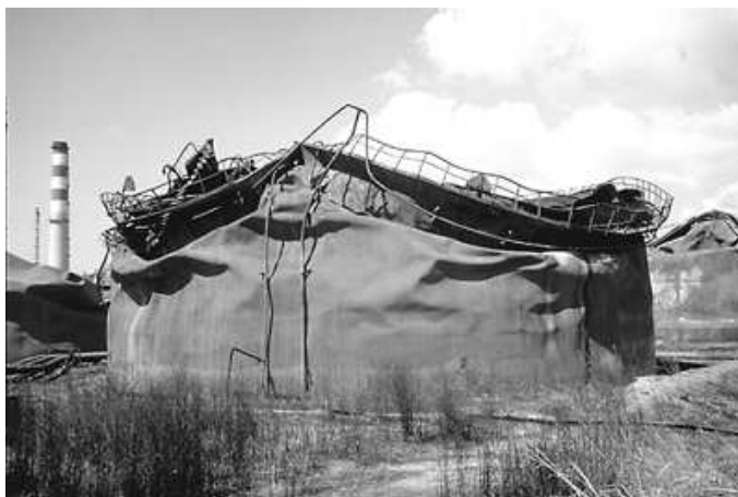
FIG. 1.5 – Dégâts causés par un incendie sur un réservoir de naphte, dans la raffinerie de Tüpras, suite au séisme d'Izmit en 1999 (source : Pacific Earthquake Engineering Research Center, Berkeley University). Cette photographie illustre un cas de réaction en chaîne entre un séisme et un accident technologique.
