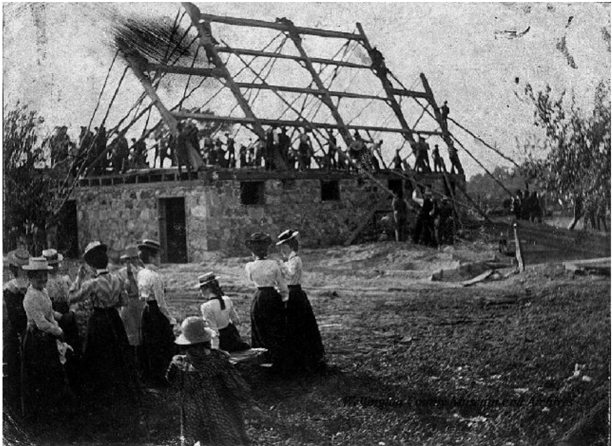
Fig. 18 : Levage collectif d'une charpente à portique pour une grange, Minto, Canada, 1901 (©wellington county museums and archives).
