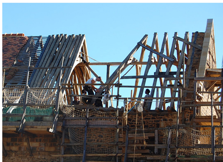
Fig. 61 : Déplacement des fermes sur la glissière dans la dernière travée du logis de Guédelon, 2008.
