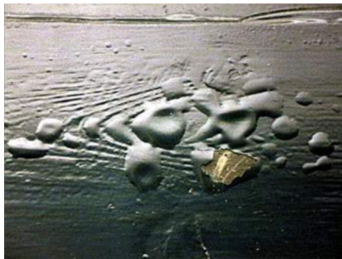
FIG. 2 – Structures de cloquage observées sur la peinture d'une poutre en bois.
