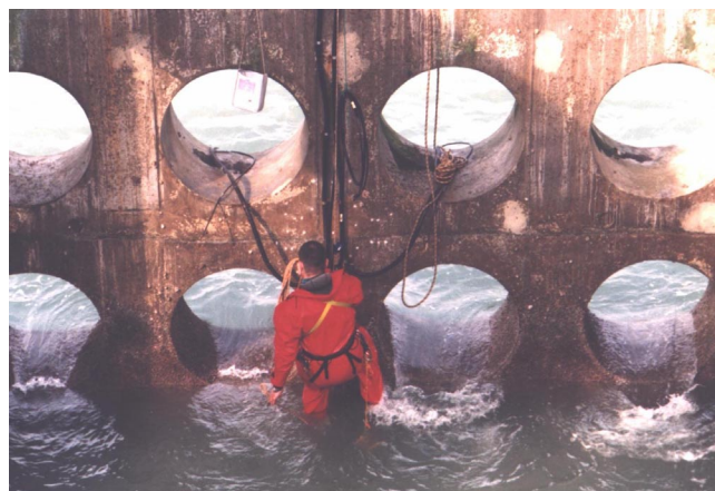
Figure 2-16 : Fixation de capteurs sur la paroi perforée.
