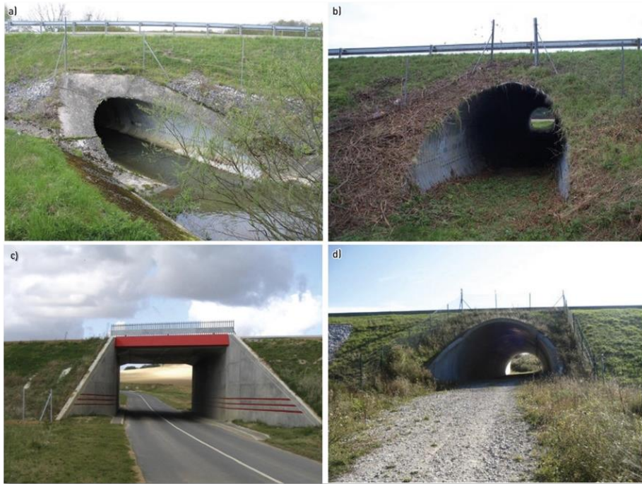
Figure 5.10. Exemples d’ouvrages de franchissement existants avec un potentiel variable d’amélioration de la connectivité (source : Sanef)
