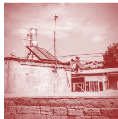
Fig. 194. Turquie, Cappadoce. Août 2015. Du solaire thermique sur tous les toits : logements récents, maisons anciennes, tous. Toute l'eau chaude sanitaire ne semble être produite que par le soleil dans cette région de la Turquie.
