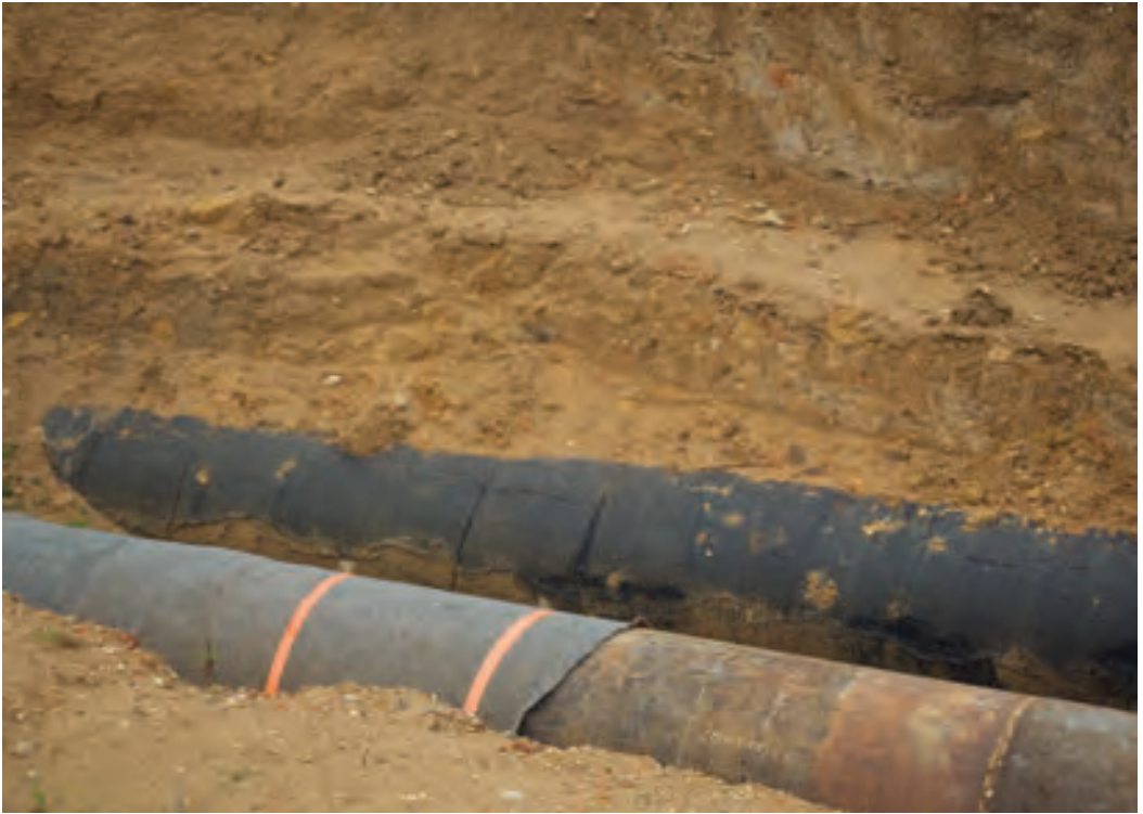
129 • Contrôle de corrosion sur le pipeline de pétrole de la Société du Pipeline Méditerranée-Rhône [février 2018].
