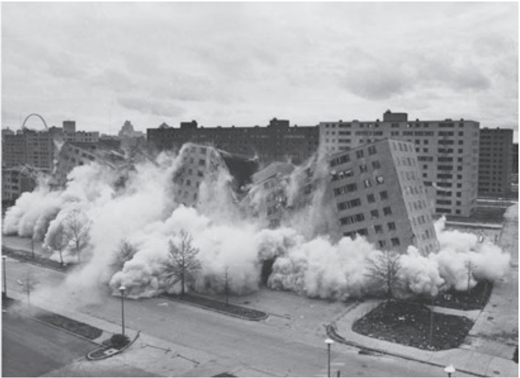
56 • Démolition de Pruitt-Igoe, le 15 juillet 1972 [U.S. Department of Housing and Urban Development].
