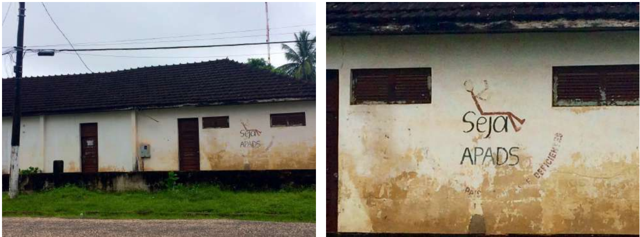
Figure 17 : Le local de l'APADS ( Segunda Rua, Traversa 15 ) à l'abandon (photos de l'auteure)
