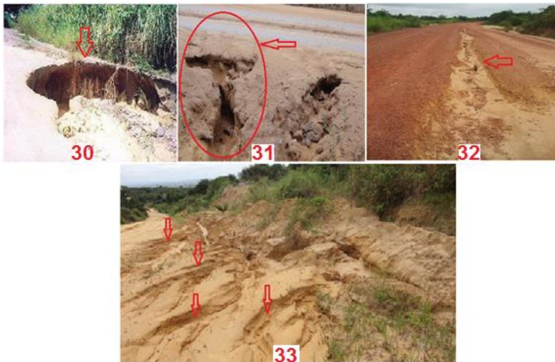
Photo 30 : Rigole en petit cratère sur la piste de Linzolo (2009), Photo 31 : Rigole en têtard sur la piste de Linzolo (2015), Photo 32 : Rigole linéaire au milieu de la piste de Mayitoukou (2014), Photo 33 : Griffures sur la route de Linzolo (2015).
