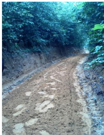
Photo 91 : Traitement défaillant des ornières vers Mayala, sur la piste Koubola-Bissinza
