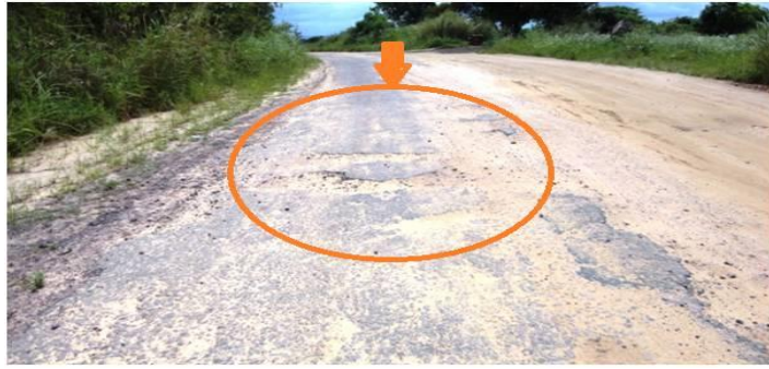
Photo 29: Nids-de-poule sur la route de Linzolo, en plein dégradation et en cours de transformation en piste en terre, par la perte des matériaux vers Touboula © Idriss M'bouka Milandou, 2013
