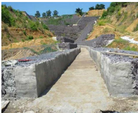
Photo 119 : Stabilisation par gabionnage d'un ravin à Kingouari - Brazzaville. ©Ndona et Truong (SA)
