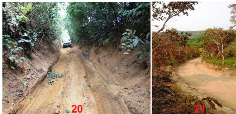
Photos 20 et 21 : Tronçons de la route de Kibossi, en tranchée © Idriss M'bouka Milandou 2014
