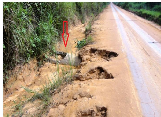
Photo 83 : Ponceau dégradé vers Saint Isidore © Idriss M'bouka Milandou, 2015
