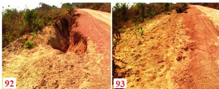
Photos 92 et 93 : Colmatage non finalisé de l'exutoire d'un ravin longitudinal sur la piste Mayitoukou-Goma tsé-tsé.
