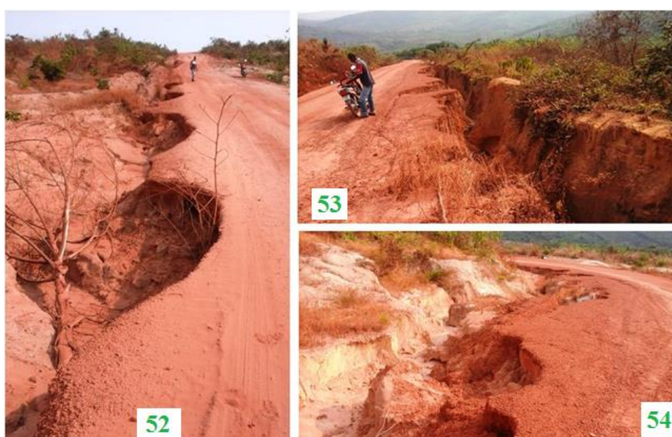
Photo 52 : Rigoles en bordure de la piste, Photo 53 : Ravine linéaire rétrécissant la piste sur une pente moyenne et longue, Photo 54 : Ravine sur un virage à pente moyenne Piste Mayitoukou-Goma tsé-tsé (P2).
