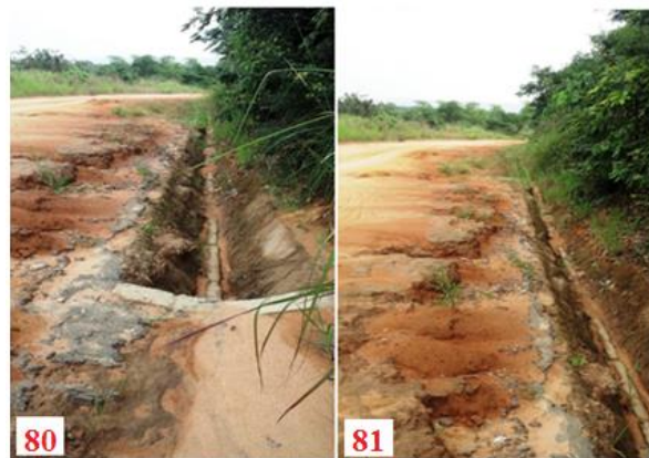
Photos 80 et 81 : Le reste d'un caniveau triangulaire latéral, vers Saint Isidore, sur le piste de Linzolo, ©Idriss M'bouka Milandou, 2014
