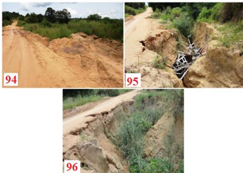
Photo 94 : Mauvais colmatage d'un ravin longitudinal à Massissia en 2013, Photos 95 et 96: Reprise et aggravation de la forme en 2014 avec une deuxième tentative de blocage avec de la ferraille.
