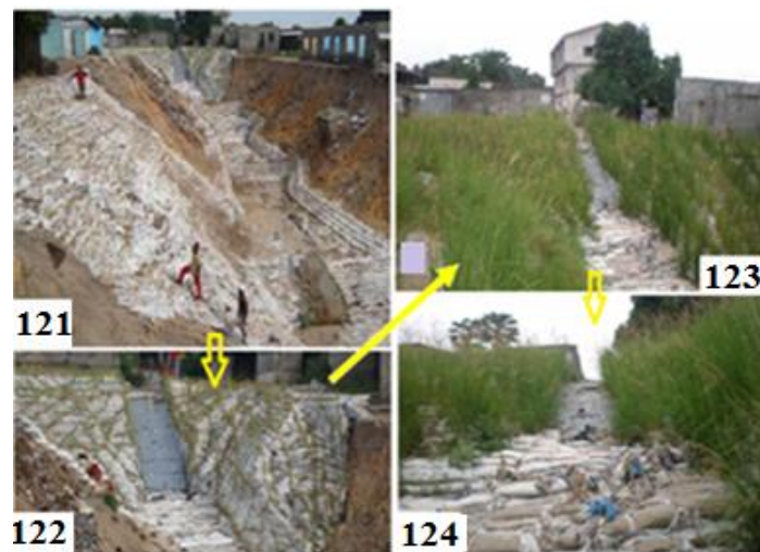
Photo 121: Ravinement régressif traité par la construction d'une digue de sacs de ciment remplis de sédiments à Brazzaville (Quartier nord-ouest de Brazzaville), Photo 122 : Planting des vétivers entre les sacs de ciments, Photos 123 et 124 : Croissance efficace des vétivers sur la digue.
