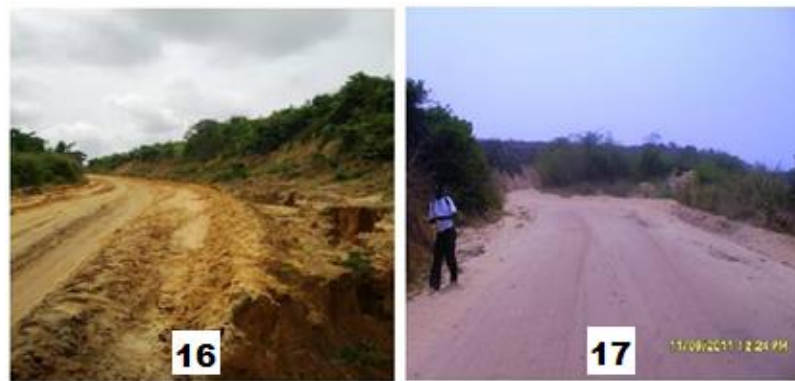
Photos 16 (2015) et 17 (2011) : Tronçons de la route de Linzolo © Idriss M'bouka Milandou, 2011
