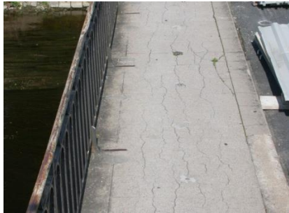
Les trottoirs sur l'ouvrage sont fissurés
