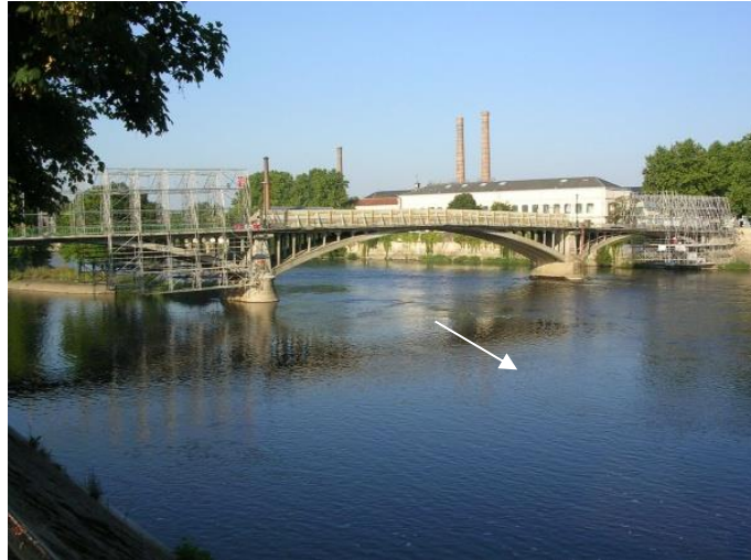
Figure IV-23 : Pont Camille de Hogues à Chatellerault (avec sens du courant de la Vienne).
