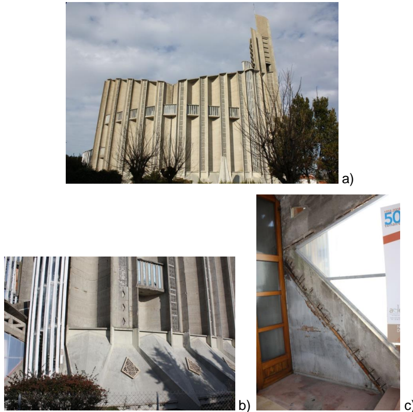
Figure II-11 : Eglise Notre Dame de Royan ; vue générale (a) ; la chapelle (b) ; le mur d'entrée (c).
