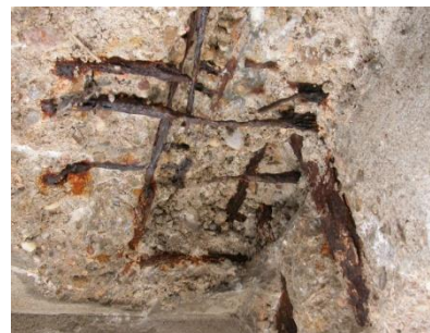
Localement la corrosion est tellement sévère que les aciers ont disparu
