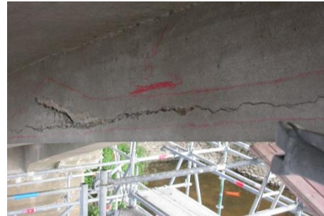
Epaufrures au niveau des poutres sur plusieurs mètres de long
