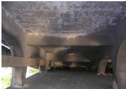
Traces importantes d'infiltration en sous-face du tablier
