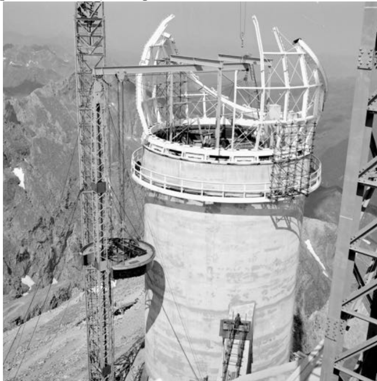
Figure 2.13 – Construction de la coupole du Télescope Bernard Lyot (probablement en 1971). | © Régie du Pic du Midi
