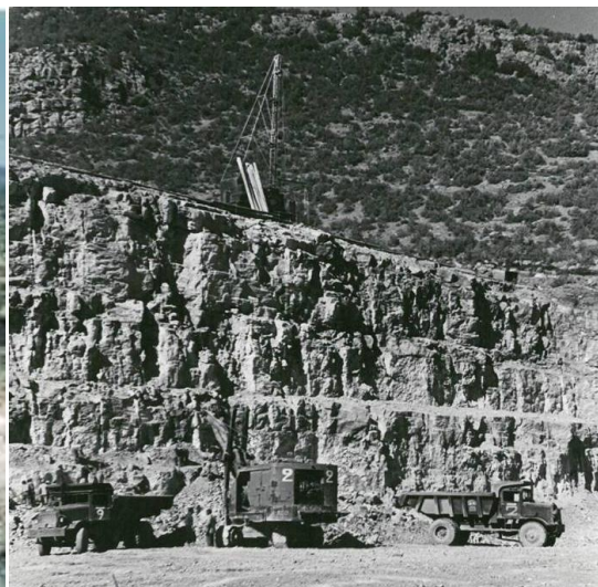
Photo 6.5 : Des engins pour transporter les matériaux de construction au site du barrage Bin El Ouidane. (Source : www.dafina.net )
