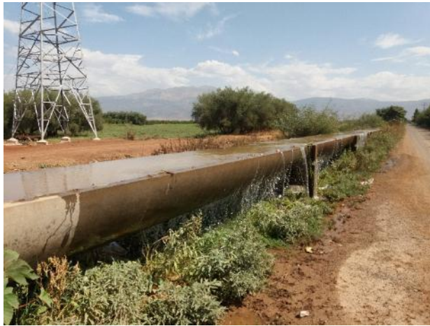
Photo 8.21 : volume important d'eau perdue par débordement.
