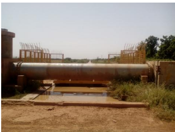
Photo 7.9 : Unité de contrôle et de transfert des eaux des canaux d'irrigation.
