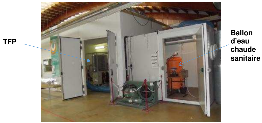
Figure 37 : Photographie d'implantation de la TFP dans les enceintes climatiques
