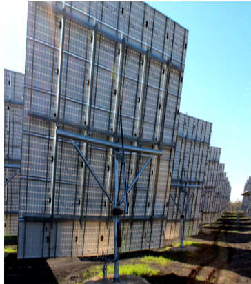
FIGURE 2.10 – Centrale de panneaux tracké sur deux axes
