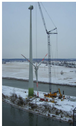
(b) Éolienne à axe horizontal modèle E-70 ayant un rotor de 71m de diamètre et une puissance de 2.3MW
