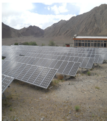
(a) Centrale solaire à panneaux fixes posés au sol
