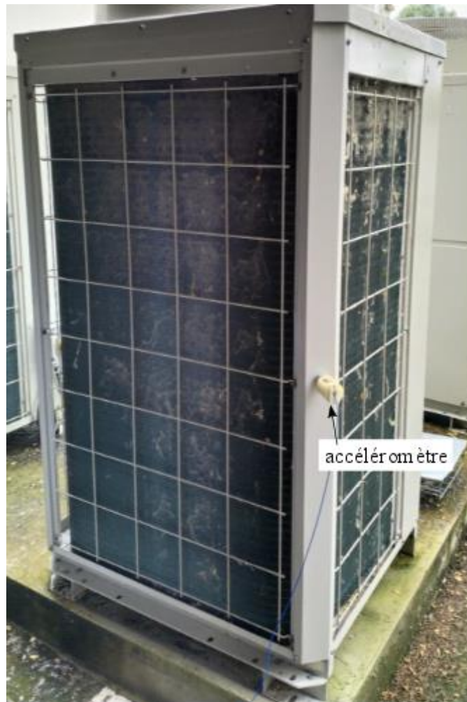
Figure 5.1 : Photo du bloc de climatisation en environnement industriel.
