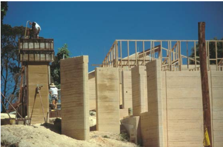
Fig 13 : Utilisation d'un coffrage métallique grimpant pour réaliser des murs trumeaux toute hauteur, sur un chantier en Australie, région de Perth (S. Maïni, début des années 1990).
