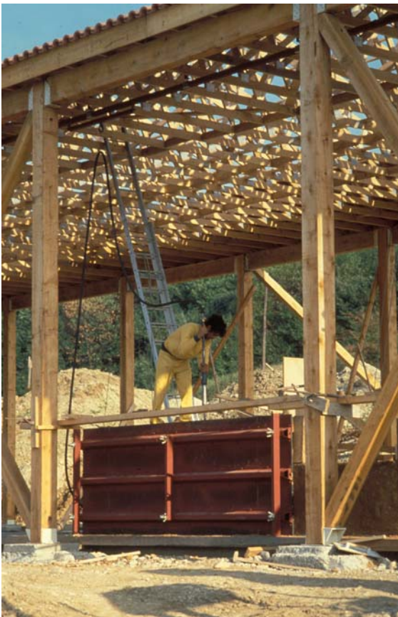
Fig. 10 : Coffrage à pisé métallique ; chantier de l'architecte Serge Jauré. Domaine de la Terre de Villefontaine, Isère, été 1984
