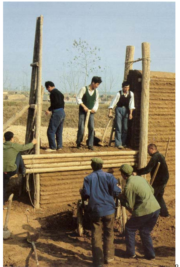
Fig. 11 : Coffrage grimpant à fûts de troncs et porte toute hauteur utilisé traditionnellement en Chine (région de Xian) pour réaliser des murs de clos (d'après Needham, 1956, in Loubes, J.P., 1988 ; p. 44.
