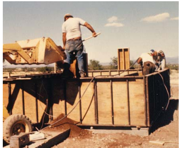
Fig. 14 : Utilisation d'un coffrage intégral en panneaux de contreplaqué et structure métallique, approvisionnement de la terre par manitou à godet. Entreprise Schmidt Builders à Saint David, sud de l'Arizona, 1981 (H. Guillaud).
