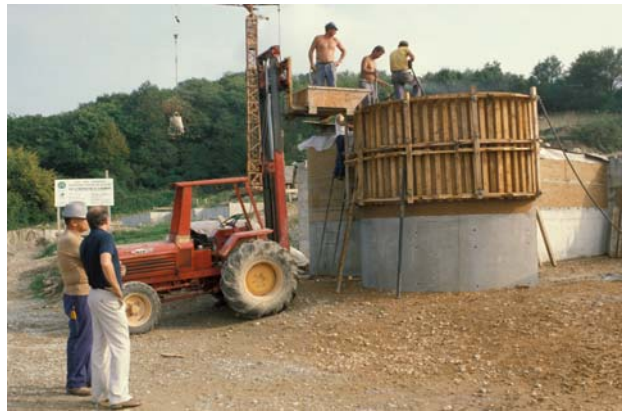
Fig. 16 a : Coffrage intégral en boisage de planches, de forme courbe, utilisé sur le chantier de Jean-Vincent Berlotier, Domaine de la Terre de Villefontaine, Isère, 1984 (H. Guillaud).
