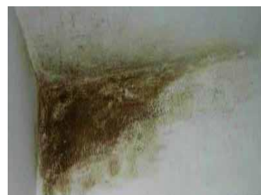
Photo 10 : Moisissures dues à un pont thermique.
