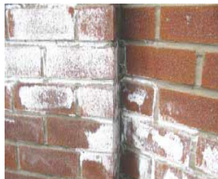
Photo 12 : Efflorescences de sels dans un mur
