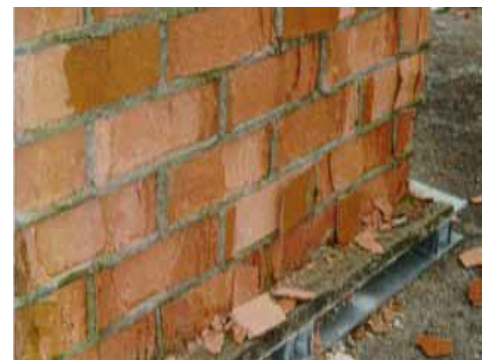
Photo 11 : Briques gélives soumises au gel
