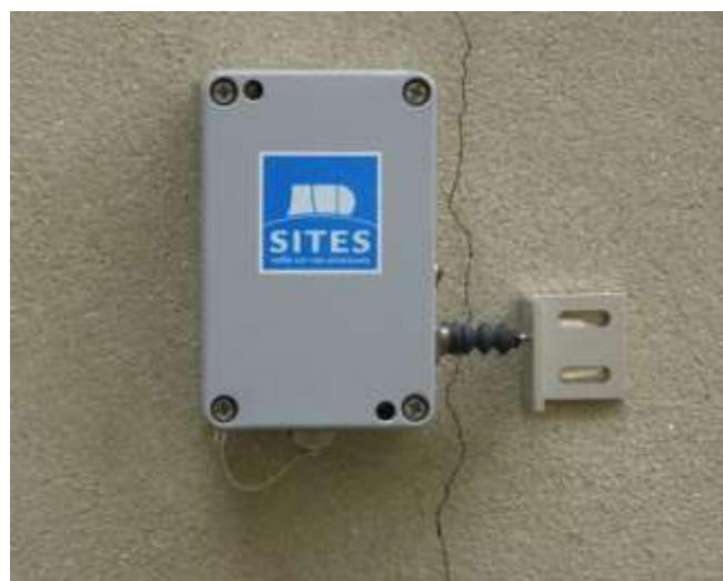
Figure I-4 Fissuromètre avec enregistreur embarqué
