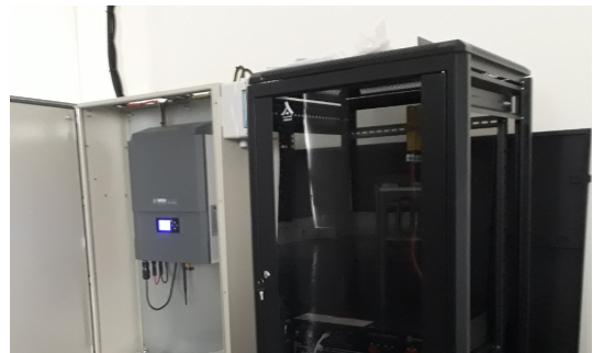
FIGURE 3.15 – Ensemble onduleur hybride connecté et batteries, qui fera l'objet des premiers tests.
