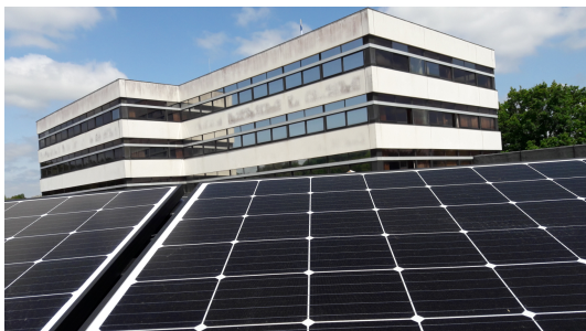
FIGURE 3.14 – Panneaux solaires installés pour la Smart and Secure Room. © Guéguen2020
