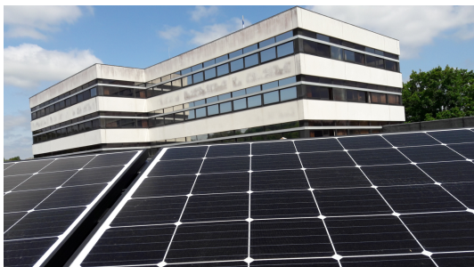
FIGURE 3.14 – Panneaux solaires installés pour la Smart and Secure Room.
