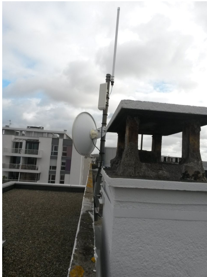
FIGURE 3.4 – Aperçu global d’une antenne ainsi que la gateway associée
