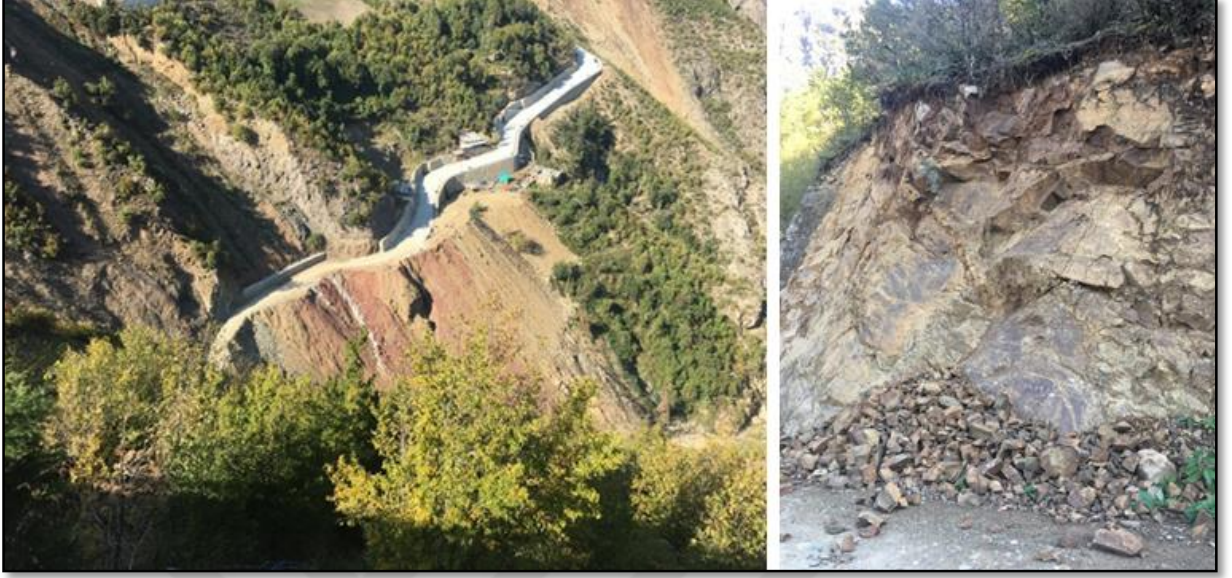
Şekil 5.2: Yolların yarattığı tahribat ve kaya düşmesi örneği.
