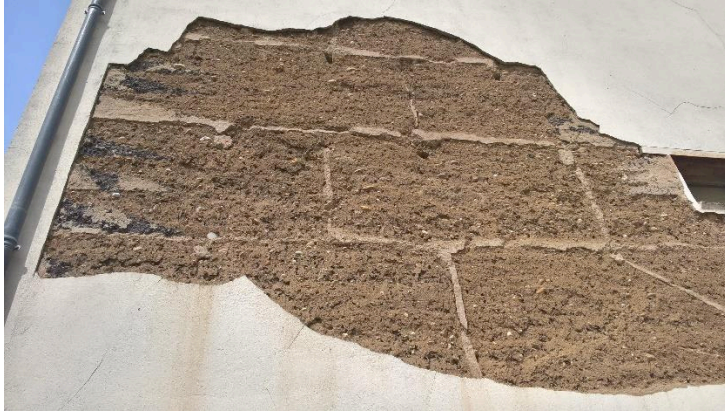
Photographie d'un mur porteur en pisé de terre perceptible du fait de l'érosion d'un enduit sur le mur d'une façade exposée Sud d'un bâtiment situé rue Bataille, dans le 8 ème arrondissement de Lyon. Photographie réalisée par Victor Villain en 2018.
