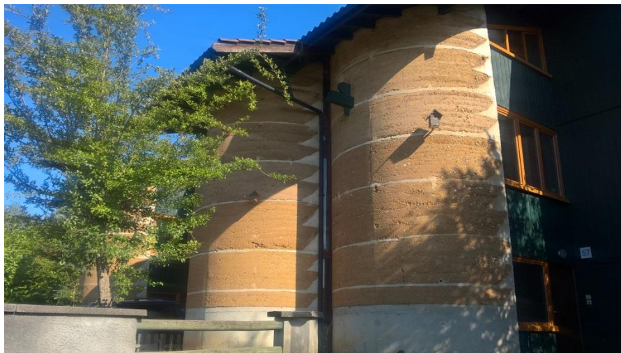
Photographies prises au Domaine de la Terre de l'Isle d'Abeau. Les angles des murs et les tableaux d'ouverture en dents de scie sont en béton de chaux constituent une protection des angles et facilitent le compactage de la terre aux extrémités des murs en pisé. Photographies prises par Victor Villain en 2017.
