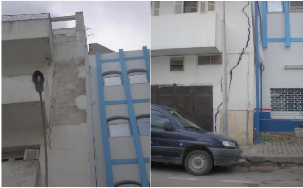
Figure 156 - Tassement d'un bâtiment identifié dans le centre - ville de Tunis (source, Bouassida et Klai, 2016)
