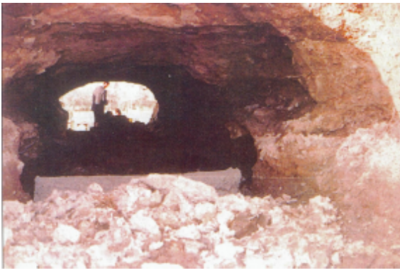
(a) Saint-Julien des Landes (France), digue construite en 1969, une érosion par écoulement interne s'est produite lors du premier remplissage.
