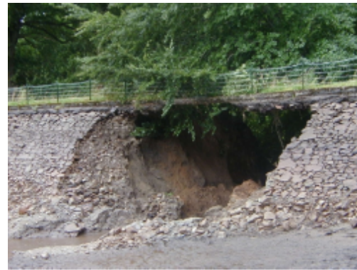
(b) Les Ouches (France), digue construite au 18 ième siècle, une érosion par écoulement interne s'est produite en 2001.
