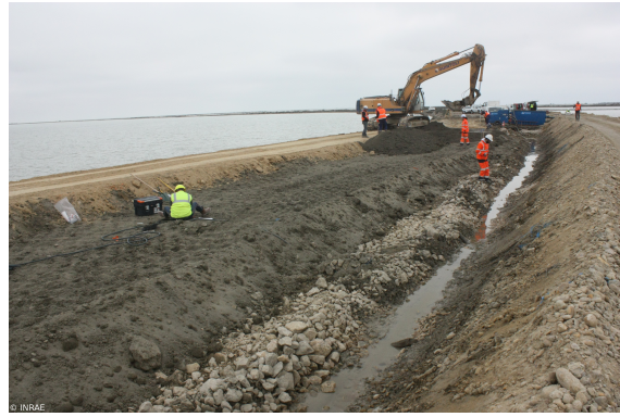
FIGURE A.2 – Plateforme en cours de construction. De gauche à droite : étang du Fangassier, digue du Symadrem, plateforme de recherche, batardeau, étang du Galabert (Archive INRAE).
