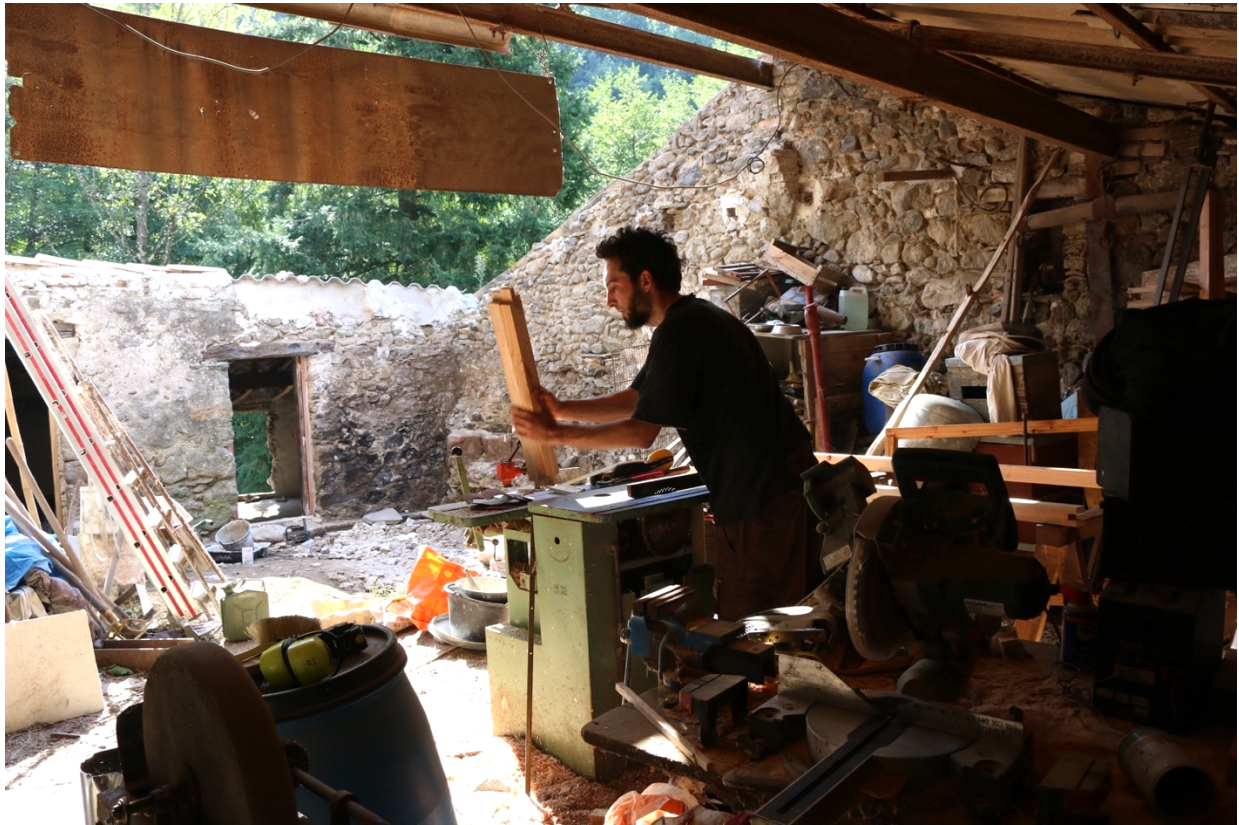
Image 45 : Le Pégelou pendant un chantier de rénovation d'une partie de la maison principale.
