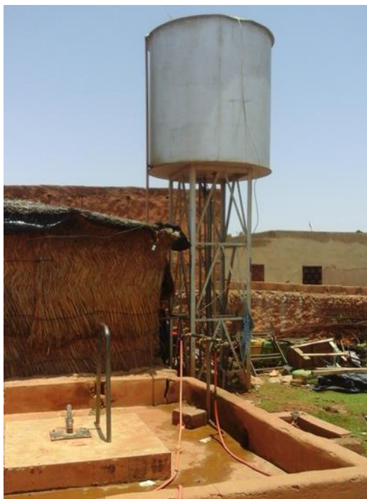
Photo n° 11: Mini-réseau à Tondigamey , un point d'eau banal d'un quartier défavorisé, rien n'indique l'alignement de dizaines de ménages dans un service d'eau en réseau. Le hangar en secco abrite le bureau du gérant et de ses agents.
