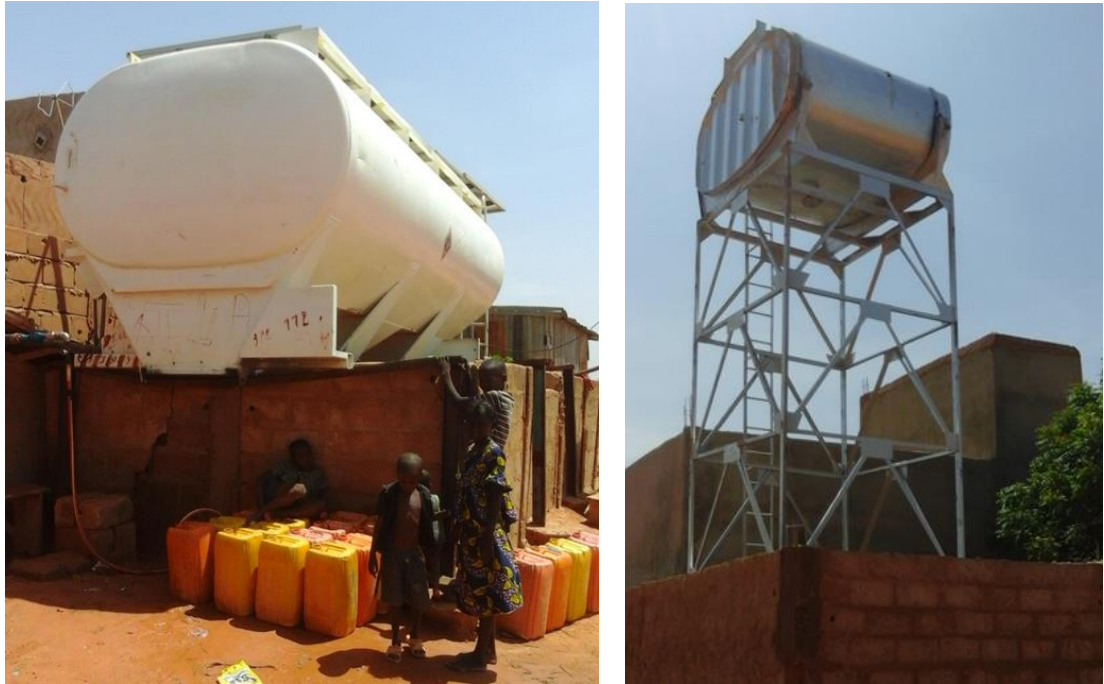
Photo 10: a) Un forage avec une citerne transformée en réservoir, seule la présence du robinet et des bidons indique qu'il s'agit d'un point d'eau collectif avec vente d'eau ; b) Un réservoir métallique dans une maison dans le même quartier.
