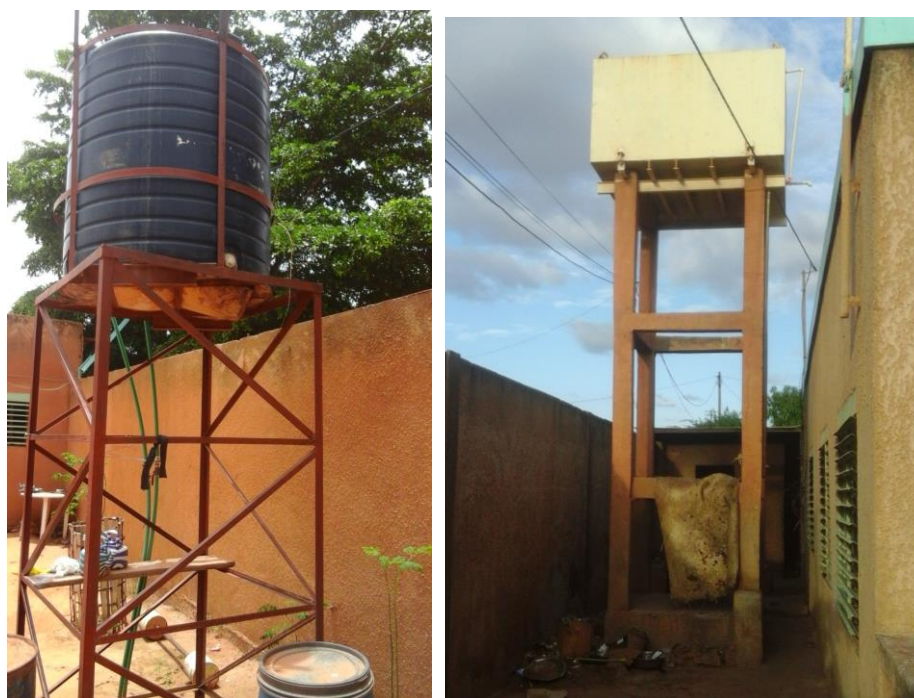
Photo n° 15 : Réservoirs de sécurité pour faire face aux intermittences quotidiennes, les réservoirs en caoutchouc sont récents.
