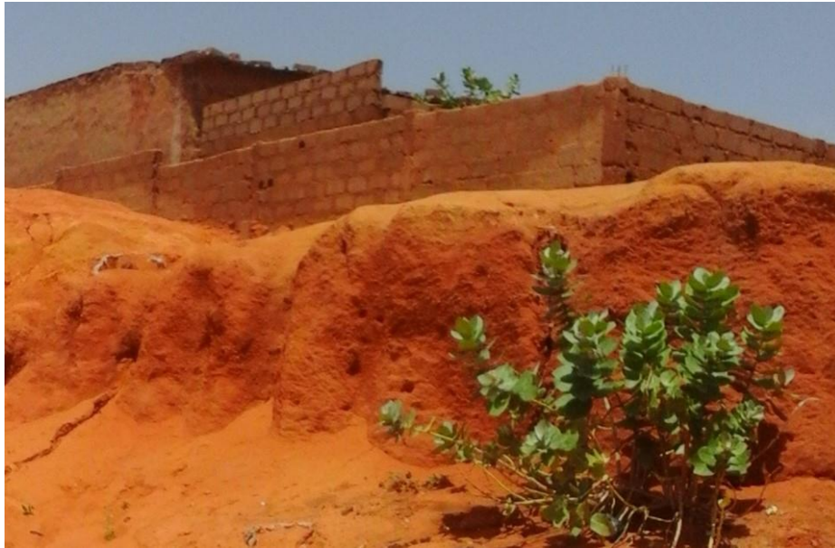
Photo n° 3 : Une maison de Tondigamey menacé d'effondrement alors que le réseau devrait s'étendre vers là-bas
