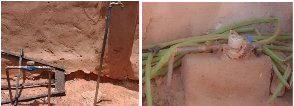
Photo n° 12: a) Compteur d'un mini-réseau, b) Compteur de la SEEN. Source : notre enquête (2016 et 2017)
