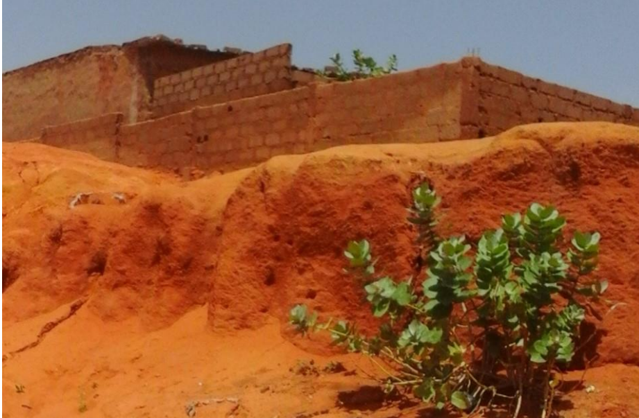
Photo n° 3 : Une maison de Tondigamey menacé d'effondrement alors que le réseau devrait s'étendre vers là-bas
