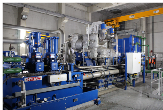
(b) Salle de la turbine de l'UEM
