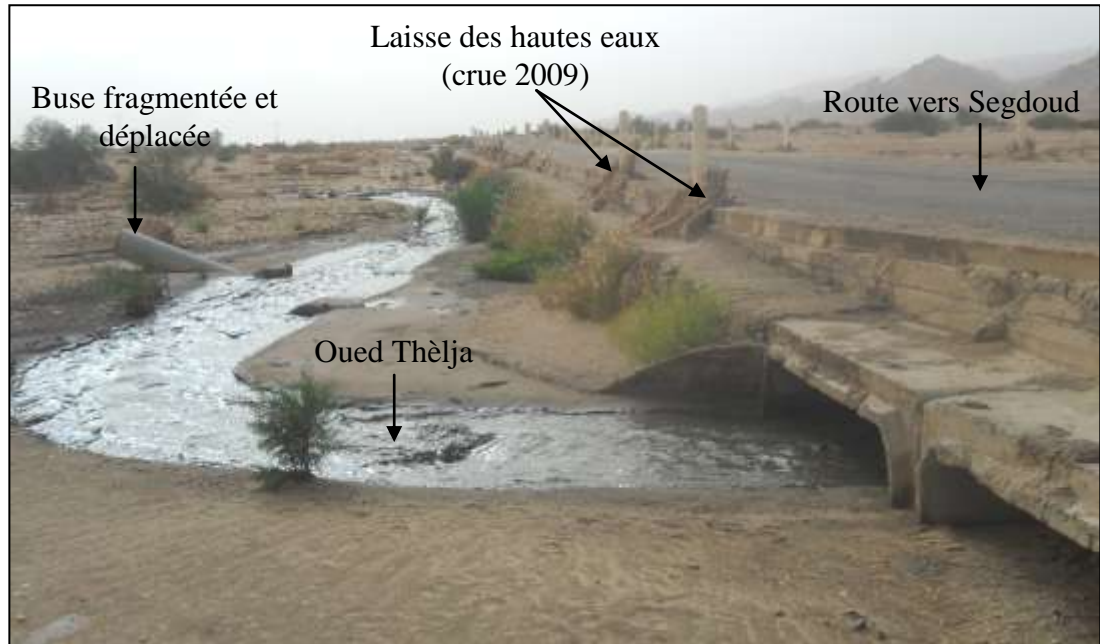
Photo n°. 52: Les eaux de l'oued Thèlja couvrant la route et le pont reliant Metlaoui et Segdoud lors de la crue de 2009
