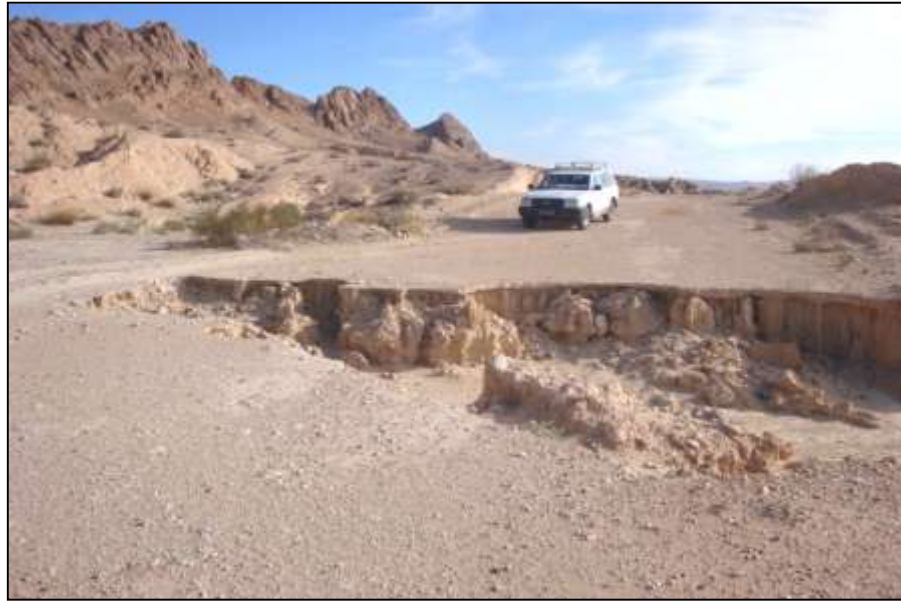
Photo n°. 59: Rupture de la piste aménagée par la CPG sur le piémont sud d'Alima - Chouabine sous l'effet de l'érosion régressive (lors de la crue de 2009)
