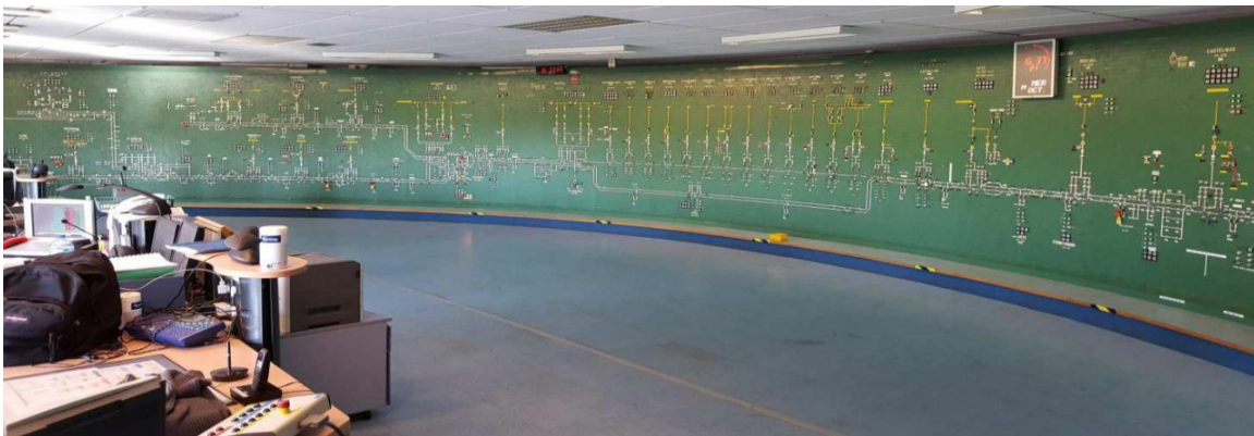
FIGURE 12 – Exemple d'un Central Sous-Station
