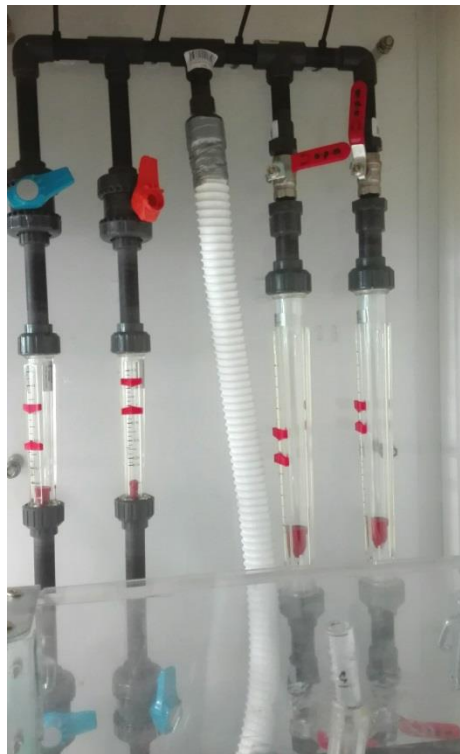
Figure 42 : Débitmètres à flotteur permettant de mesurer le débit d'air circulant dans l'unité pilote
