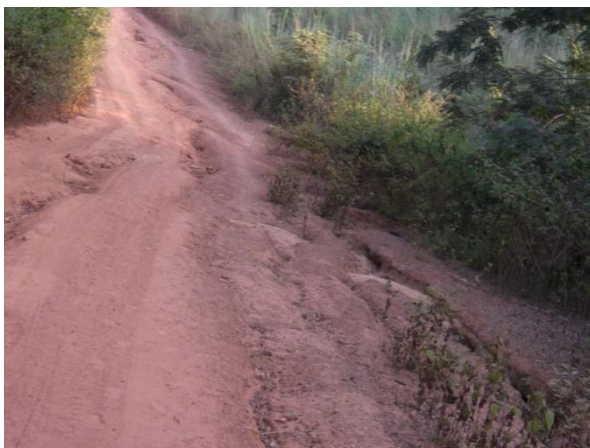
PHOTO 75 : PISTE MADINGOU – MABOMBO- SIBITI EN 2010, RÉHABILITÉE EN 2008 PAR LE FONDS ROUTIER (LATÉRITE ET OUVRAGES D’ART).
