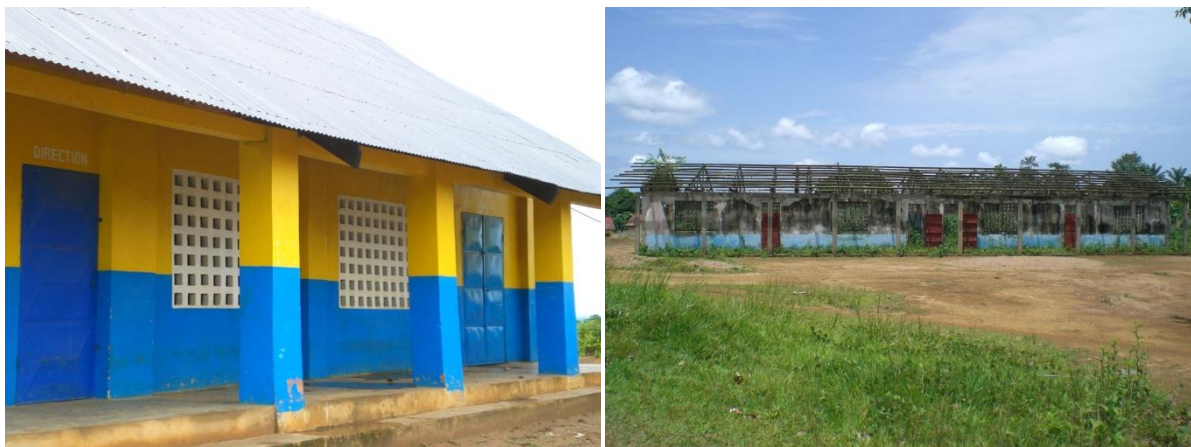
PHOTOS 86 : ÉCOLE DE KIBANGOU CENTRE RÉHABILITÉE GRÂCE AUX FONDS DE LA MUNICIPALISATION ACCÉLÉRÉE ; À DROITE, L'ÉCOLE TCHIKOU DE MOSSENDJO, POUR LAQUELLE LES TRAVAUX DE LA MUNICIPALISATION ACCÉLÉRÉE N'ONT JAMAIS ÉTÉ TERMINÉS.
