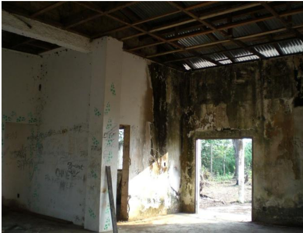
PHOTO 20 : LA MAISON D'ARMAND SEPO À LOUDIMA EN 2009; DÉTRUITE ET OCCUPÉE PAR LES NINJA, SEULS LES TROUS DU TOIT ONT ÉTÉ REBOUCHÉS.
