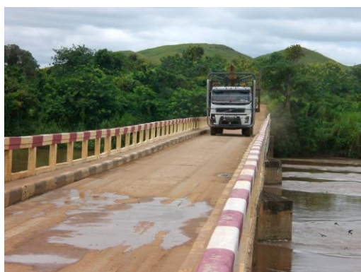
PHOTO 50 : GRUMIER (VIDE) SUR LE PONT DU NIARI, 2010
