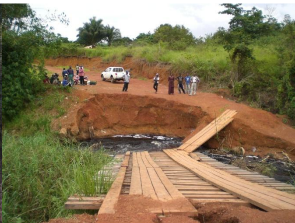
PHOTO 76 : PONT DE KINGOUÉ RÉNOVÉ EN 2009 « PAR LES FONDS DES VILLAGEOIS » (E_126), DÉJÀ DÉTRUIT EN 2011. UN SYSTÈME IMPROVISÉ DE TRANSBORDEMENT PAR JAKARTAS A ÉTÉ MIS EN PLACE.
