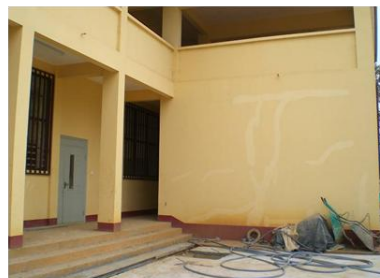
Lycée de l'excellence (déjà fissuré...)
