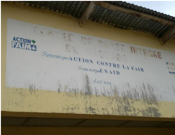
PHOTO 31 : BÂTIMENT DU CSI DE MABOMBO RÉHABILITÉ PAR ACF EN AOÛT 2002 SUR UN FINANCEMENT USAID (PHOTO 2010).
