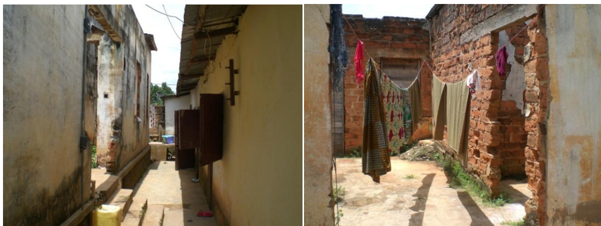
PHOTOS 102 : CHEZ CHANTAL, À DOLISIE : SA MAISON, (À GAUCHE ET PHOTO DE DROITE), A ÉTÉ PILLÉE, LES TÔLES ET LES OUVERTURES VOLÉES. ELLE VIT DÉSORMAIS AU FOND DE SA COUR (À DROITE DE LA PHOTO), DANS DES PETITES PIÈCES AMÉNAGÉES QU'ELLE PARTAGE AVEC 3 FAMILLES.
