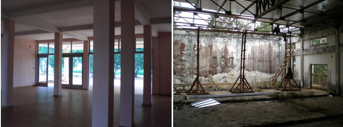
PHOTOS 38 : LA PRÉFECTURE DE LA LÉKOU MOU À SIBITI EN 2010 : SI LE HALL D'ENTRÉE A ÉTÉ RÉHABILITÉ, LES TRAVAUX SONT EN COURS DANS LES SALLES DE RÉUNION.
