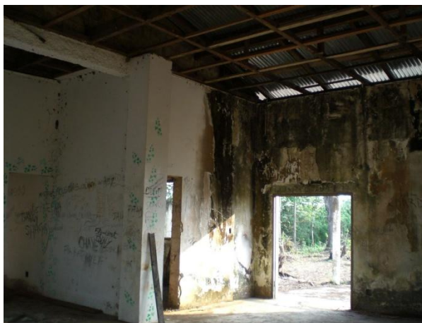
PHOTO 20 : LA MAISON D'ARMAND SEPO À LOUDIMA EN 2009; DÉTRUITE ET OCCUPÉE PAR LES NINJA, SEULS LES TROUS DU TOIT ONT ÉTÉ REBOUCHÉS.
