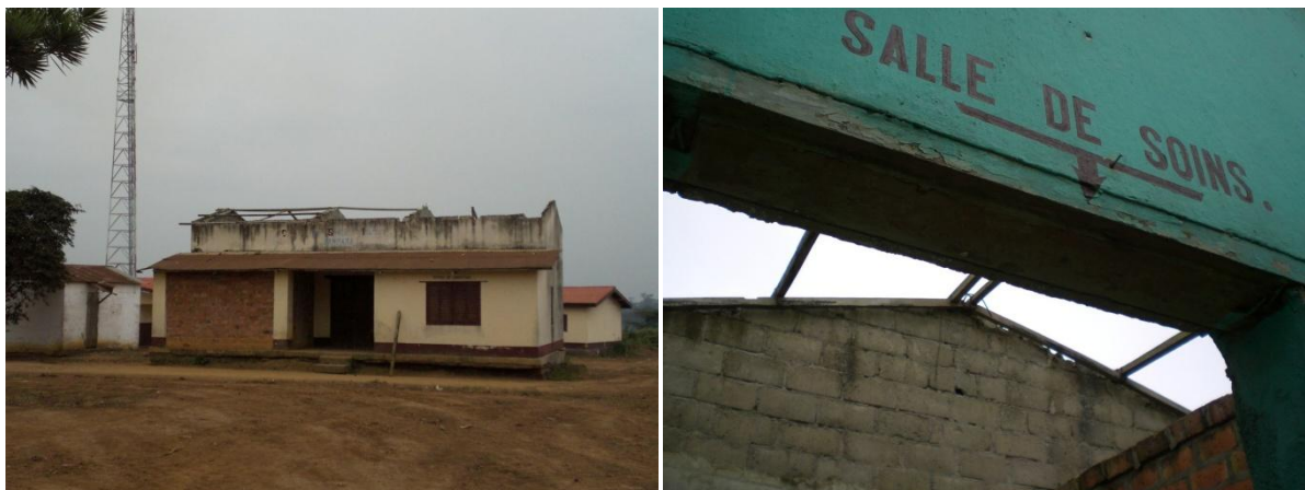
PHOTOS 82 : LE CSI DE BAMBAMA EN 2010 : LE TOIT A ÉTÉ ENLEVÉ PAR UNE TORNÉE (E_380).
