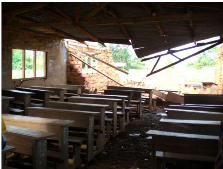
PHOTO 79 : LES BÂTIMENTS DE L'ÉCOLE DE YAMBA SONT TOMBÉS À CAUSE DU VENT ET DE LA PLUIE. LES ENFANTS FONT QUAND MÊME COURS À L'INTÉRIEUR (E_128, 2009).
