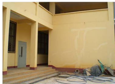
Lycée de l'excellence (déjà fissuré...)
