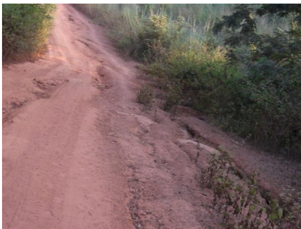
PHOTO 75 : PISTE MADINGOU – MABOMBO- SIBITI EN 2010, RÉHABILITÉE EN 2008 PAR LE FONDS ROUTIER (LATÉRITE ET OUVRAGES D’ART).
