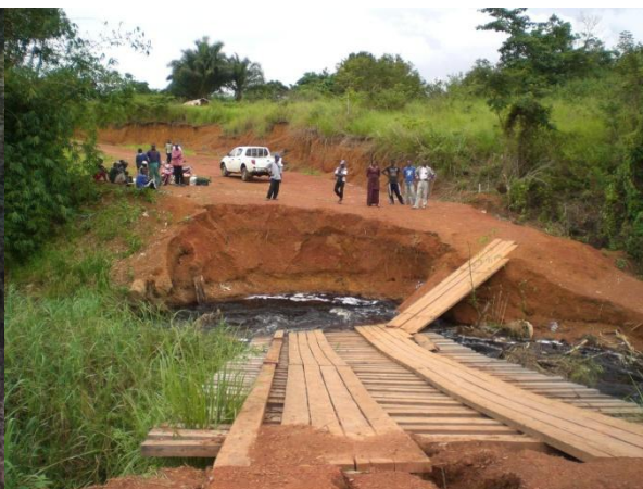
PHOTO 76 : PONT DE KINGOUÉ RÉNOVÉ EN 2009 « PAR LES FONDS DES VILLAGEOIS » (E_126), DÉJÀ DÉTRUIT EN 2011. UN SYSTÈME IMPROVISÉ DE TRANSBORDEMENT PAR JAKARTAS A ÉTÉ MIS EN PLACE.
