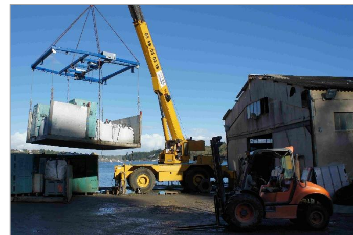
Figure 197 – Les équipements portuaires de Bréhat Logistique sur la route de Saint-Julien
