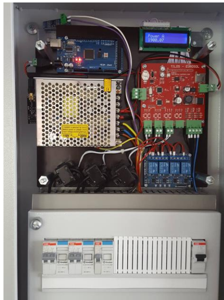
Figure I-16: Installation chez le client du système de mesures avancé et du dispositif de communication avec la SCADA (source : Facebook Tilos Horizon)
