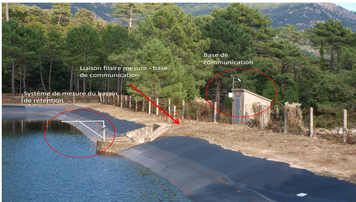
Figure 33 : Point de mesure de niveau et de qualité de l'eau dans bassin
