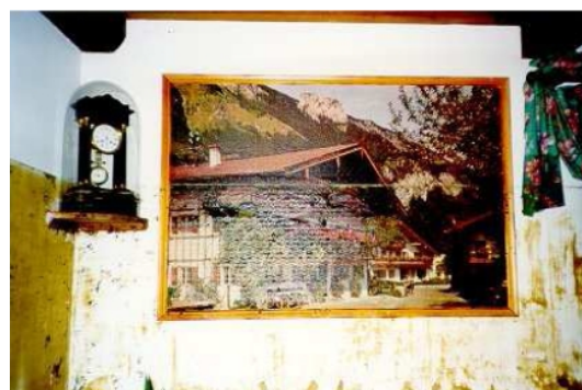
Limon et humidité sur une mur intérieur
