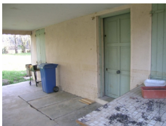
Traces de limon sur un mur extérieur
