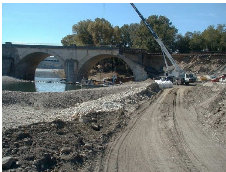
FIG. 10.14 – Pont ferroviaire de Ners (Gard) après la crue de 2002 vu depuis l'aval. L'érosion de la berge aval en rive gauche et le creusement d'une fosse à l'aval immédiat du pont témoignent des vitesses importantes d'écoulement sous le pont au moment de la crue. La vitesse maximale est évaluée à 5 m/s en fonction de la section de l'ouvrage et des estimations de débits effectuées par ailleurs.
