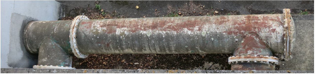
FIGURE 5.3.2 – Tuyau d'alimentation des souffleries
