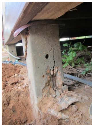
Figure 6 : Fissure du béton à cause de la corrosion La fracture expose l'ensemble des armatures au sein de la structure. Source : Flickr [26]
