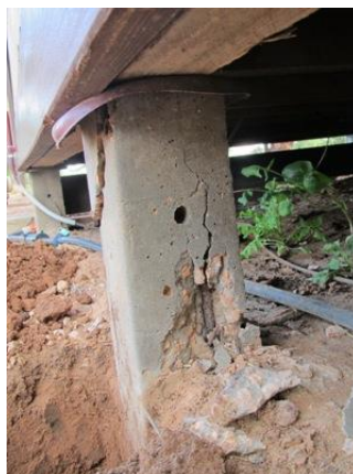
Figure 6 : Fissure du béton à cause de la corrosion La fracture expose l'ensemble des armatures au sein de la structure. Source : Flickr [26]
