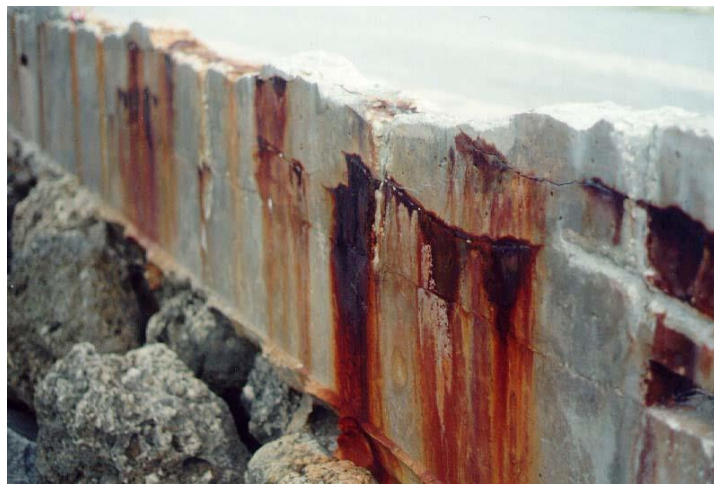
Figure 7 : Évacuation par les fissures ouvertes des dérivés d'oxyde de fer Source : Kennedy Space Center [27]
