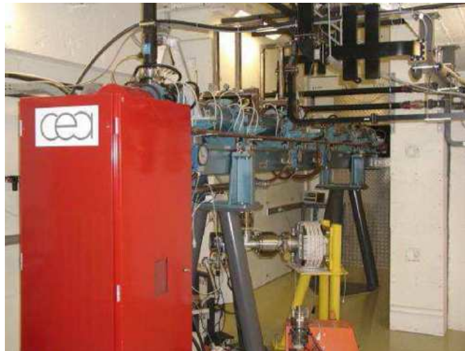
Figure 2.19 : Accélérateur d'électrons de l'installation SAPHIR [Carrel10].
