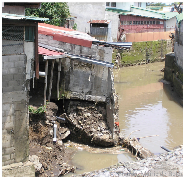
Maison détruite après l'inondation de 2007 à Belén
