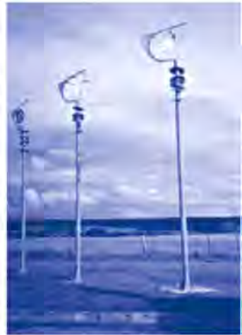
Onidelle, Aulande et Elancelle, 3 barpes éoliennes Aire du bois de Chaumont (A31)
